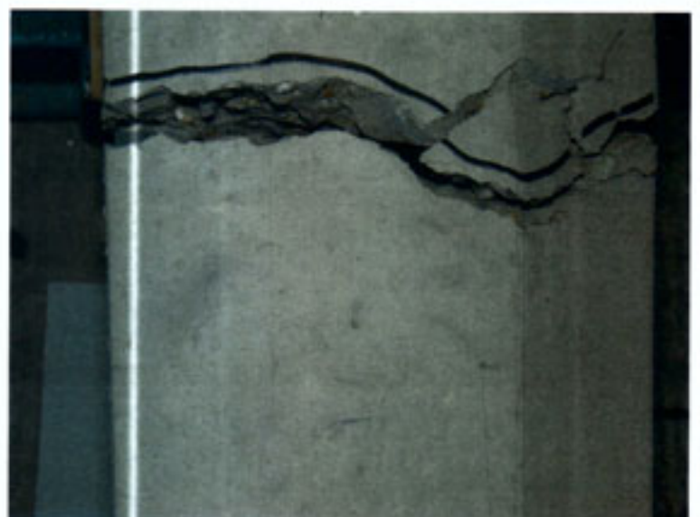
- Stĺpik č.1 – detaily porušenia -
